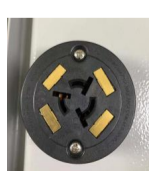
IPX6 - Evidência de NÃO ingresso de água na tomada do relé fotoelétrico
