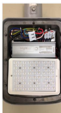
IPX6 - Evidência de NÃO ingresso de água no alojamento do controlador da amostra.
